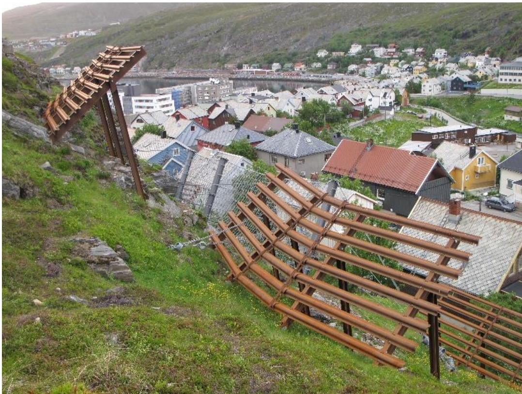
Figur 10. Eksempel på skredsikring mot bebyggelse i Hammerfest (Foto: Tom Erik Ness)
