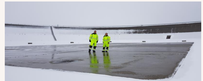
Vi utviklet og følger opp bergvarmeanlegget for bakkevarme til avising av betongen i motortestområdet Oslo Lufthavn Gardermoen
