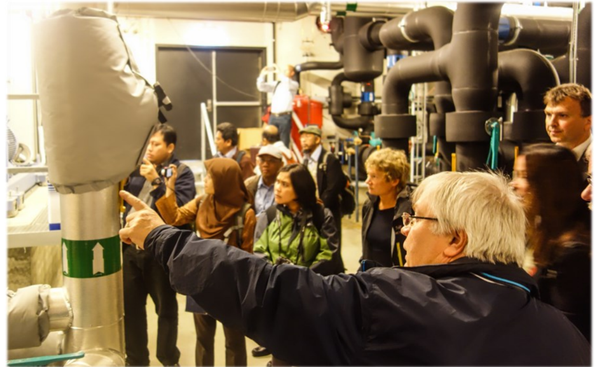
Tekniske rom HVL Kronstad,
